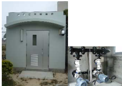
6. 仲間増圧ポンプ施設
