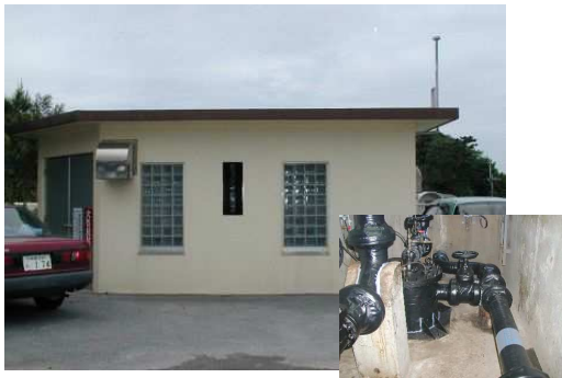
5. 前田増圧ポンプ施設
