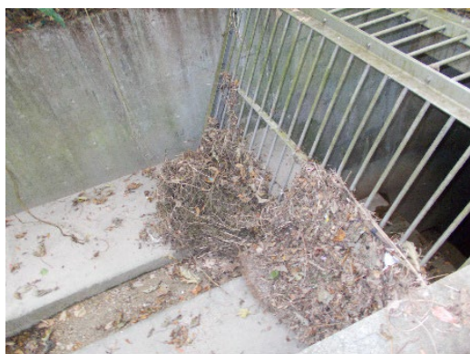
導水トンネル入口に付着するゴミ
