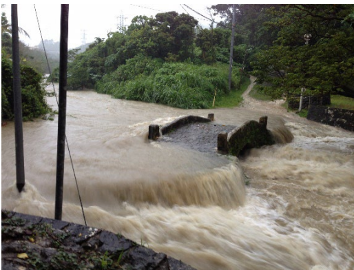
増水時の牧港川の状況(当山橋への越流)
