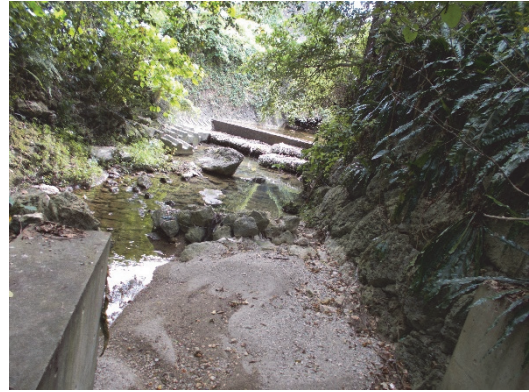
安波茶橋（導水トンネル）上流に堆積する土砂、石
