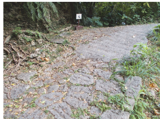
石畳上に舗装されたコンクリート (南側入口付近の斜面)
