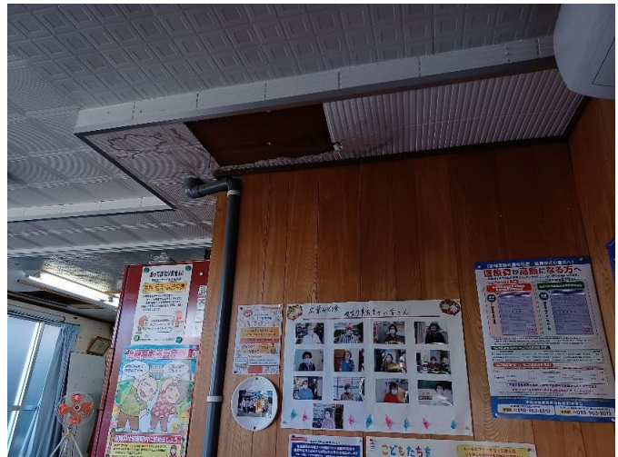
天井板が剥がれている
