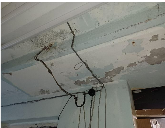
雨漏りしている
