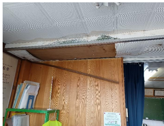
雨漏りしている
