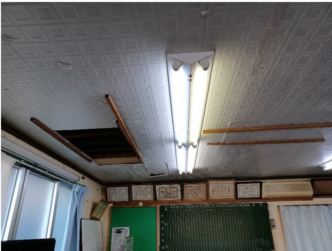
天井板が剥がれている
