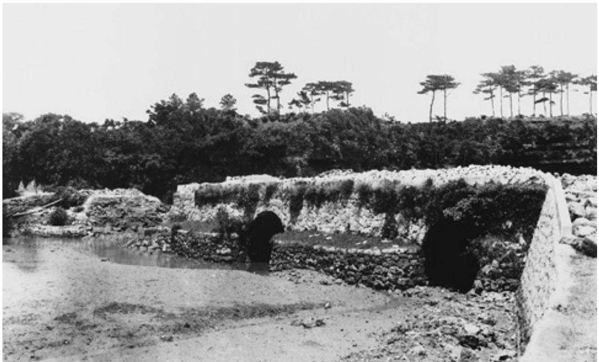
P L .32 「牧港橋」昭和 9 年 撮影／田辺泰 早稲田大学建築学科所蔵 橋の一部が崩落している。崩落した部分は通称「レンガ橋」と称される橋で、明治時代に レンガで補修されたといわれる。また、橋の後方は牧港岩山の東側に延びる一連の丘陵 で、牧港貝塚や牧港遺跡が所在した。
