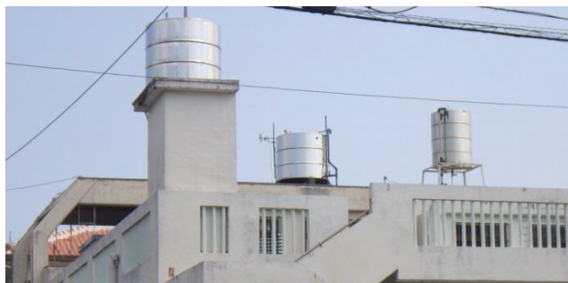
屋上タンク設置の好ましくない例
