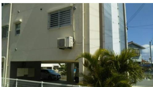
空調室外機の事例
