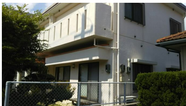
バルコニー下に瓦面が隠れている
