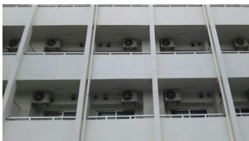
室外機の好ましくない設置の事例
