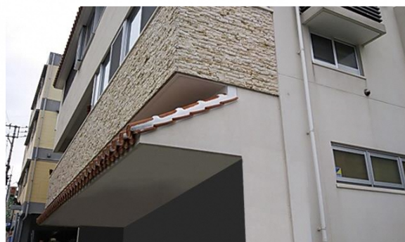
2階持ち出し部分の下に瓦が食い込んでいる
